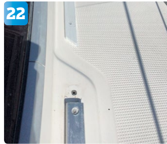
22 Där originalskenan och den nya skenans ska integreras lämnas en öppning så att vatten ska kunna rinna mellan dem och överbyggnaden då det regnar eller blir överbrytande sjö.
