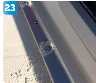
23 Därpå är det dags att borra och skruva fast genuaskenorna. Varje M6-skruv dras fast underifrån med en mutter och två brickor. Allt är rostfritt. Det är A och O att använda rikligt med tätningsmassa på alla skruvhål.
