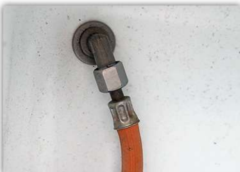
Rörgenomföringar från flaskutrymmet ska vara täta.
