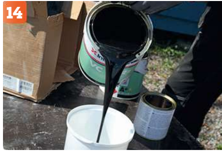
14 När botten är renblästrad ska ytan förseglas. Dels för att få ett skydd mot vatteninträngning, dels för att få en lättskött yta. I det här fallet används VC-TAR tvåkomponents epoxifärg.
