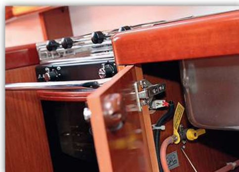
Apparatavstängningsventilen sitter i ett skåp bredvid spisen. Lätt att nå utan att böja sig över en brinnande låga.
