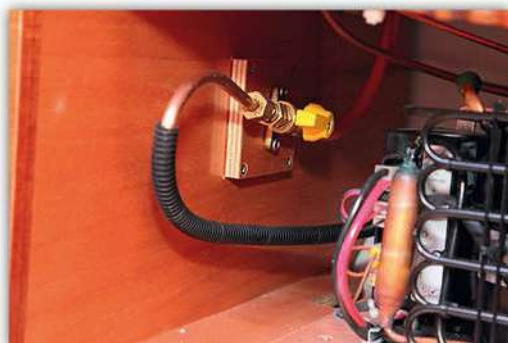
Elektronik intill gasolkomponenter är inte optimalt. Allt som kan ge upphov till gnistbildning ska vara skilt från gasolinstallationen.
