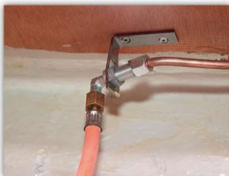
Alla skarvar och kopplingar i gasolinstallationen ska vara tillgängliga för inspektion.
