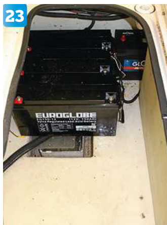
23 Sedan är det dags att placera de nya batterierna intill vattentankarna.
