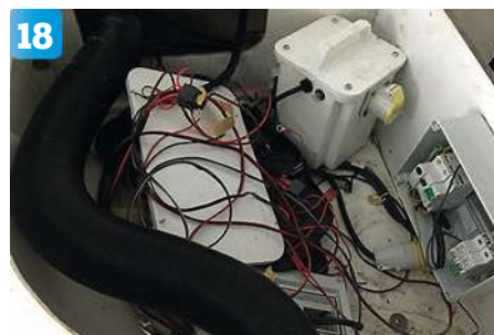
18 I det här stuvfacket i sittbrunnen på styrbordssidan finns bland annat elcentralen och 110-volts-transformatorn. Dessa ska flyttas till ett nytt utrymme under sittbrunnsturken.
