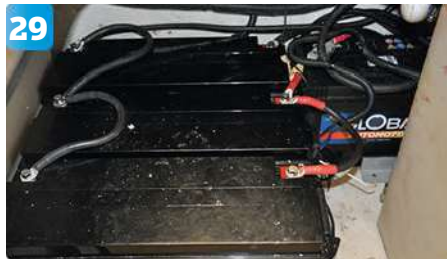
29 Från de två strömbrytarna drar han även 35-kvadratskablar till de två nya batteribankerna i stuvutrymmet. Dels en stor batteribank för underhållsladdning på 300 Ah, dels en liten bank för underhållsladdning på 150 Ah. Från startbatteriet på 110 Ah drar han två 70-kvadratskablar direkt till startmotorerna dit generatorkablaget är draget i original.
