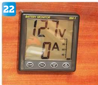
22 Batteriövervakningen börjar omedelbart utvärdera batteribankens status. Dock är det först efter att inställningarna justerats och några förbrukare kopplats in, såsom lampor eller annat, som den kan ge rätta siffror.
