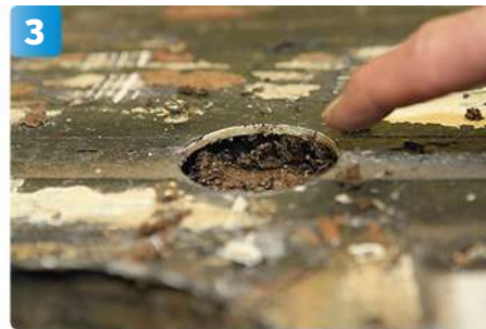
3 På andra ställen avslöjades genomblöt balsa. Laminatet måste öppnas och repareras.
