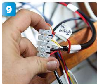
9 Kopplingsplinten i verkligheten, försedd med den extra kabeln till startbatteriets minuspol.
