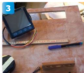
3 Babordsskåpets frontpanel har här fått ett något större hål för radion och ett nytt hål mättas ut för Nasacentralens display. Nere till höger syns hålet efter det gamla 12 V-uttaget.
