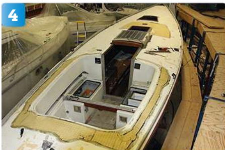
4 All gammal teak borttagen. De skadade delarna av sandwichdäcket är reparerade och fyllda med nytt distansmaterial.
