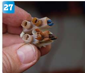
27 På styrbordssidan upptäcks denna bov, en sönderoxiderad sockerbit genom vilken all styrbordsel gått, inklusive lanternorna. Nya kablar och don avhjälper felet.
