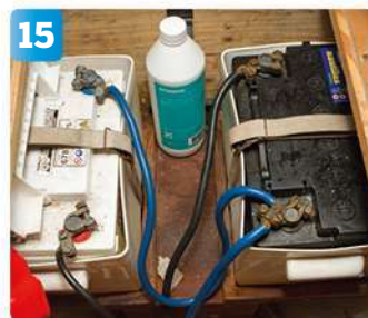
15 Batteriutrymmet i förpiken – innan modifiering. Det gamla förbrukningsbatteriet till vänster och det gamla startbatteriet till höger ska kopplas samman och utgöra förbrukningsbank.
