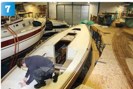
7 Här har det nya teakdäcket först lyfts åt sidan. Båtens plastdäck tätas och spacklas innan limmet stryks på.
