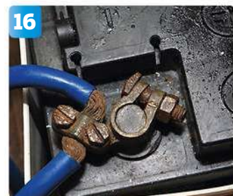
16 Två av batterikabelskorna var rejält oxiderade och behövde bytas.
