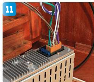
11 När radions multikontaktskablar kopplats till rätt högtalare är det bara att plugga in kabeln i radion. Säkringen satt dock fel vid leverans och först efter att den flyttats till ett annat stift fungerade radion.
