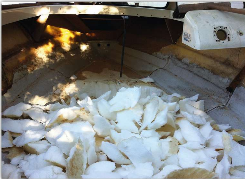
All inredning, skott och knän inklusive durk samt säckvis med vattensjukt flytskum från tomrummet mellan inner- och ytterskrov revs ut. Sex kubikmeter sopor kördes till tippen.
