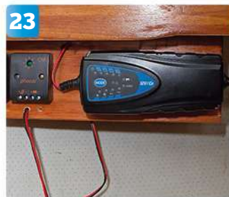
23 En träpanel monteras under babordsskåpet och på den fästs 230 V-batteriladdaren som ansluts till landströmsuttaget intill. Två laddningsregulatorer monteras också på brädan, en för varje solcellspanel.
