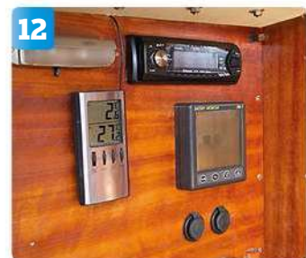
12 Efter att batterimonitor, radio och 12 V-uttag kopplats rätt sätts panelen tillbaka på sin plats.
