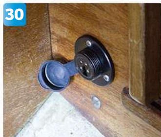
30 Här är hankontakten monterad på sitt skott, i väntan på att masten ska komma med honan.
