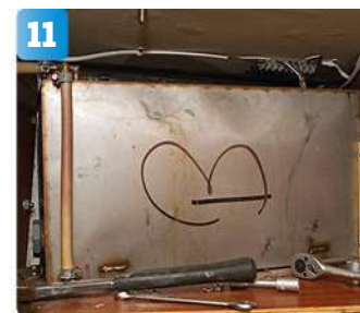
11 Septiktanken blottlagd. Uppe till vänster syns luftningsslangen som går upp till en genomföring i ruff-taket. Uppe till höger syns en svåråtkomlig "sockerbit" med kablar till både läslampor och lanternor.
