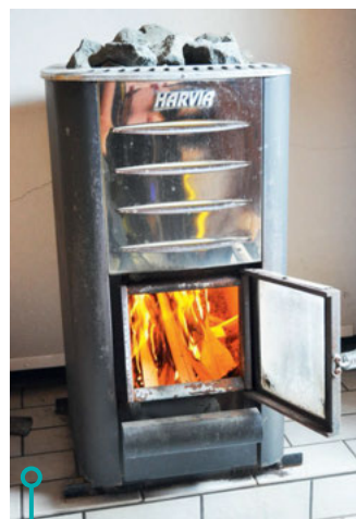
På en kvart har aggregatet fått upp värmen till behagliga 60-70 grader.
