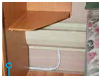
Vattenburen värme och golvvärme finns även i den gamla Kabevagnen.
