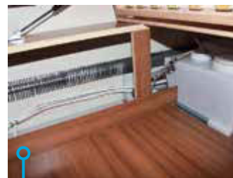
Knausvagnen har Alde vattenburen centralvärme och golvvärme från samma tillverkare.
