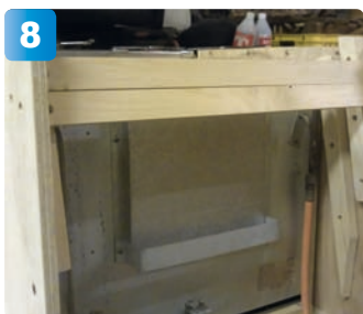
8 Bakom spisen ska han ha ett lock som ska kunna dras fram och läggas ovanpå spisen för att skapa mer arbetsyta. Därför skruvar han fast "skenor" av trä som locket ska kunna glida ner i.
