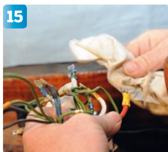
15 Nu är det kablarnas tur att rengöras.
