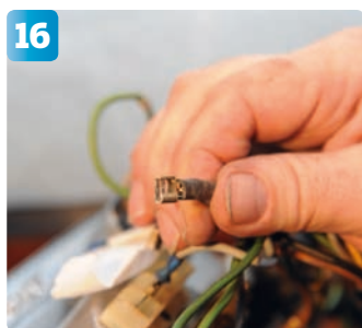
16 Trasiga och korroderade kabelskor byts ut mot nya.
