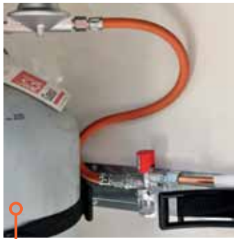
Läckindikator på gasolnläggningen i Cabby.
